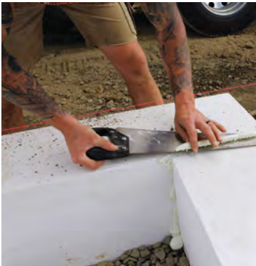
FILL AND FLUSH
